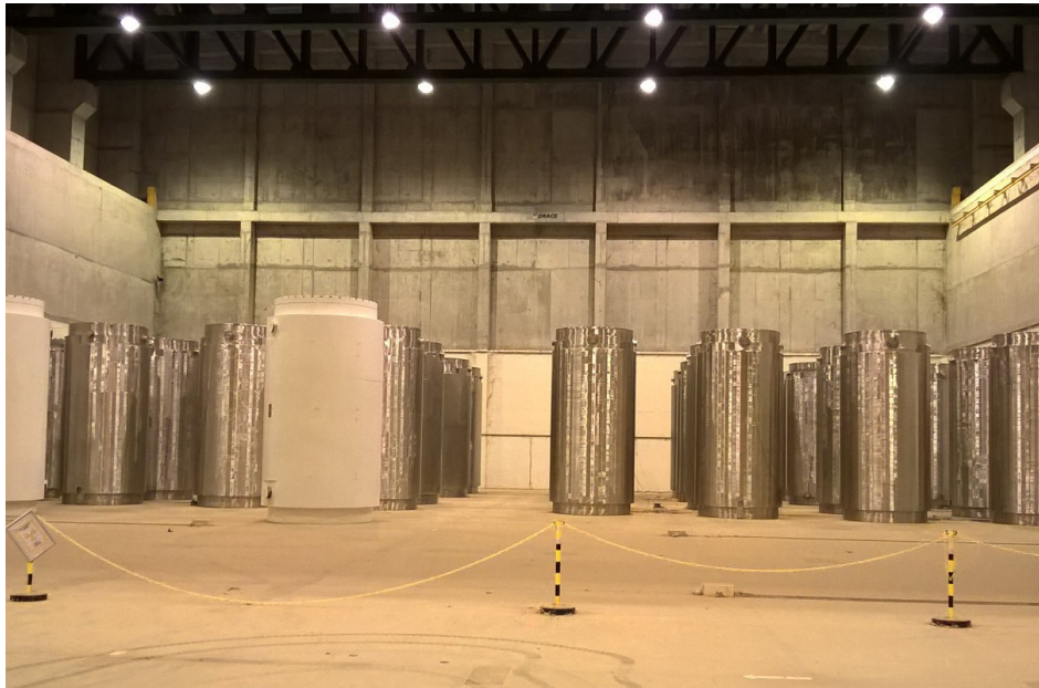
Imagen del interior del ATI de la Central Nuclear Trillo.
