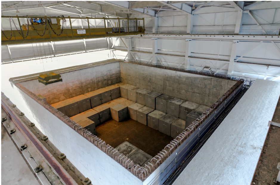
Imagen de llenado de una celda de almacenamiento de RBMA.
