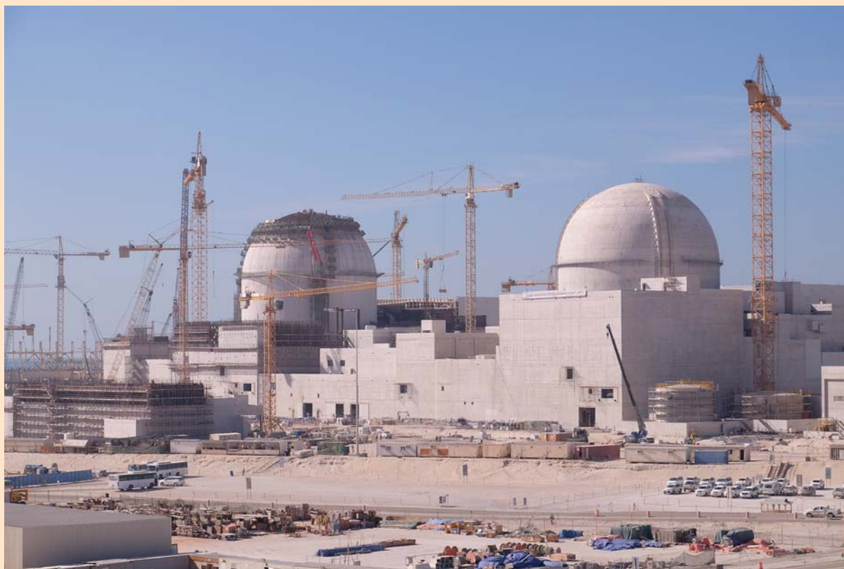
La central nuclear de Barakah (Emiratos Árabes Unidos), que fue conectada a la red eléctrica en 2020, es la primera central nucleoelectrica del país. El Organismo apoyó la creación de la instalación con misiones de capacitación y examen.
