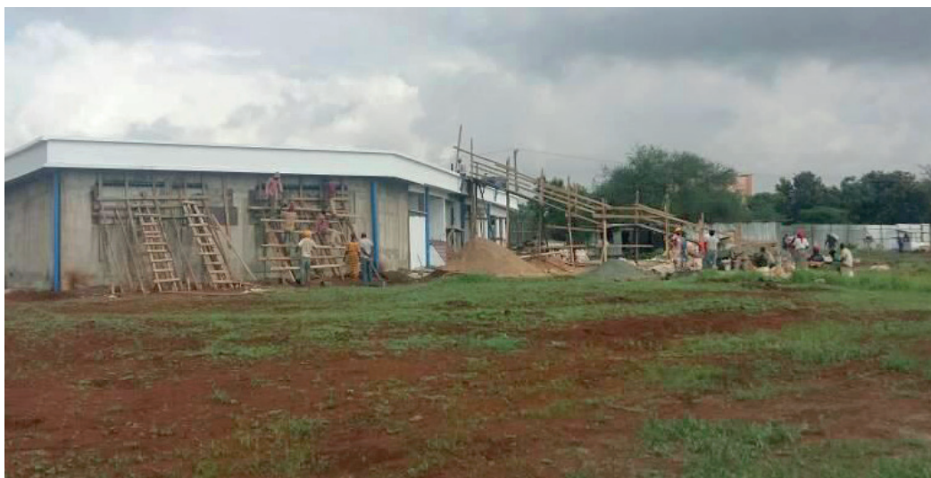
Primera fase de construcción del laboratorio de uranio de la Comisión de Energía Atómica de Tanzania.
