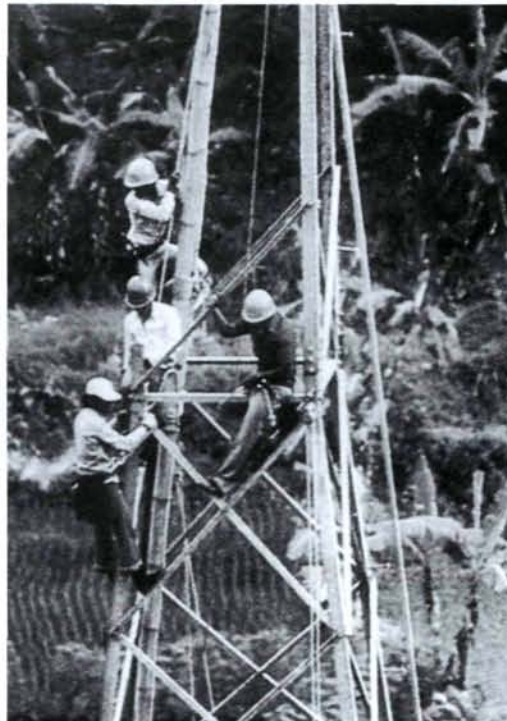
En Asie du Sud-Est et dans d'autres régions en développement, on prévoit de doubler la puissance installée au cours des 20 prochaines années. Sur notre photo, vérification d'une ligne à haute tension en Indonésie. (Photo EdF)
