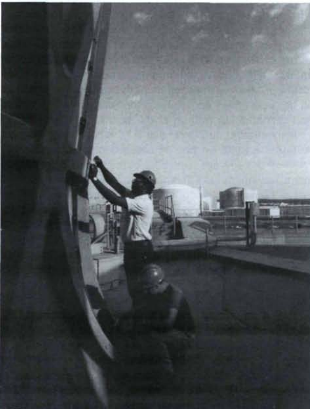
Centrale nucléaire Catawba (Etats-Unis).
