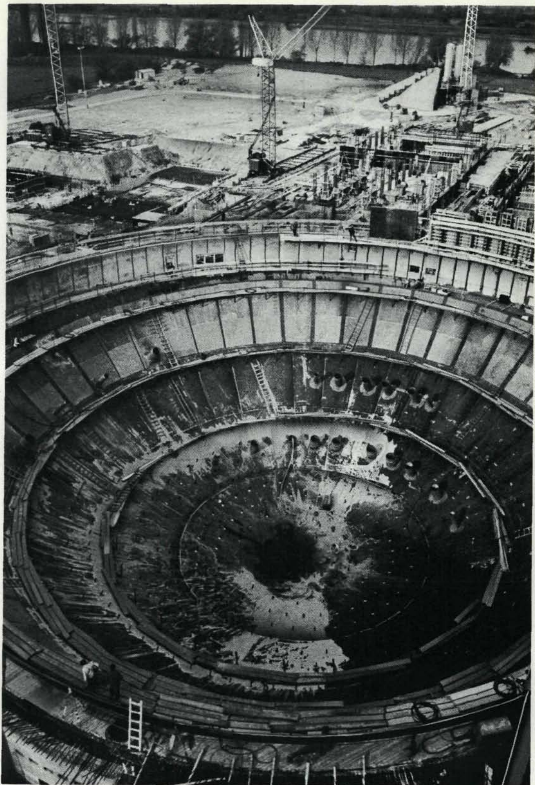
Ce chantier de construction près de Biblis sur le Rhin ressemble à un immense amphithéâtre. Il fait partie de la plus grande centrale nucléaire d'Europe.
