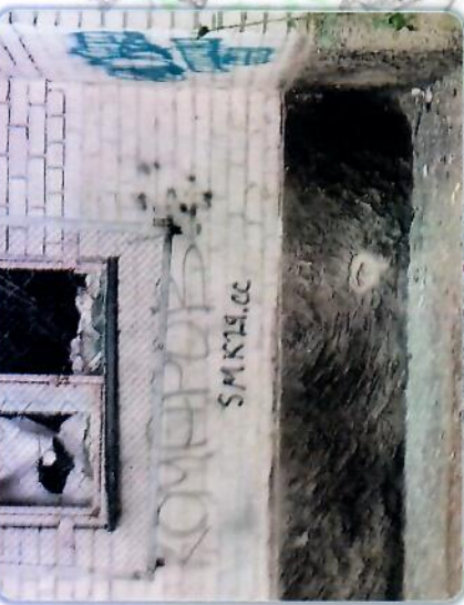
4.11.2023 г. один удар БПЛА по зданию жилого дома по адресу: ул. Набережная, д. 24
