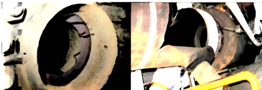
Fig. B.7. Seccionamiento de doble frente de la conducción de agua de alimentación y tubería de agua de alimentación rota
