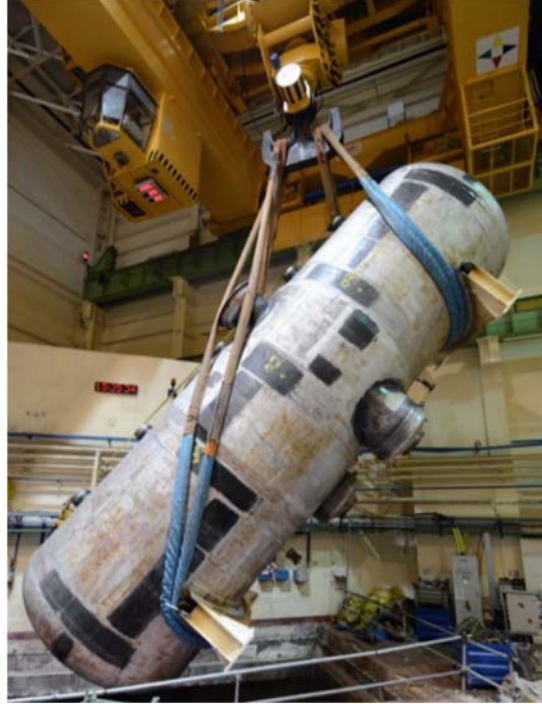
الشكل ألف-١٢ - إزالة آخر دفعة من مولدات البخار البالغ عددها ١٢ وذات وزن يبلغ ١٤٥ طناً من الوحدة V-1 من محطة بوهونيتسه للقوى النووية في سلوفاكيا. (الصورة من: شركة JAVYS للقوى النووية والإخراج من الخدمة)
