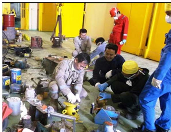
Подготовка по проведению операций по кондиционированию радиоактивных отходов в Индонезии. Фото: Сурьянторо/Национальное агентство по ядерной энергии (БАТАН)
