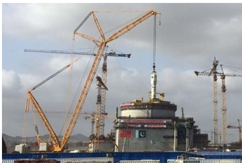
Рис. А-2. Строительство на энергоблоке № 2 АЭС «Карачи», Пакистан, сентябрь 2017 года (фото: Китайская ядерно-техническая корпорация — КЯТК)
