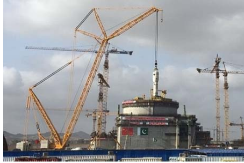
الشكل ألف-٢. أعمال الإنشاء في وحدة كراتشي ٢، باكستان، أيلول/سبتمبر ٢٠١٧. (الصورة من: شركة الصين للهندسة النووية (CNEC))
