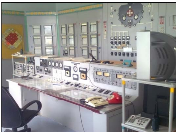
UZH9005 : Dispositifs de contrôle-commande des années 1960 remplacés par des technologies modernes.
