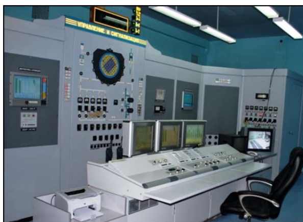
UZB9005 号项目：由该项目支持的现代仪器仪表和控制系统。
