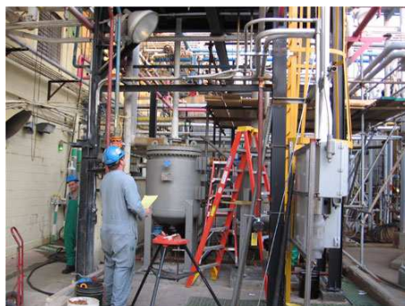
Fig. A-10 Nouveau vaporisateur de fluorure d'hydrogène à l'installation Metropolis de Honeywell, Illinois (États-Unis d'Amérique). (Photo : Coverdyn)
