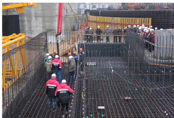
图 A-4. 2013 年 11 月 6 日，白俄罗斯的首座核电站在奥斯特洛韦茨场址开工建设（照片由白俄罗斯核电站建设指挥部提供）。
