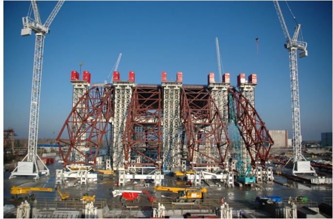
الشكل ألف-١٨ - تجميع الاحتواء المأمون الجديد الخاص بالوحدة الرابعة في محطة تشيرنوبيل للقوى النووية (الصورة: محطة تشيرنوبيل للقوى النووية).
