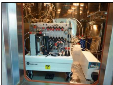
Installations de médecine nucléaire à l'École de médecine nucléaire (FUESMEN) de Mendoza (Argentine) – projet ARG/6/010.
