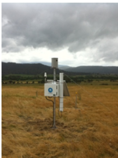
Fig. D.1. Instalación COSMOS en una pradera de Australia (fotografía por cortesía del Dr. Chris Smith, de la Organización de Investigación Científica e Industrial del Commonwealth (CSIRO): Tierra y Agua, Canberra).
