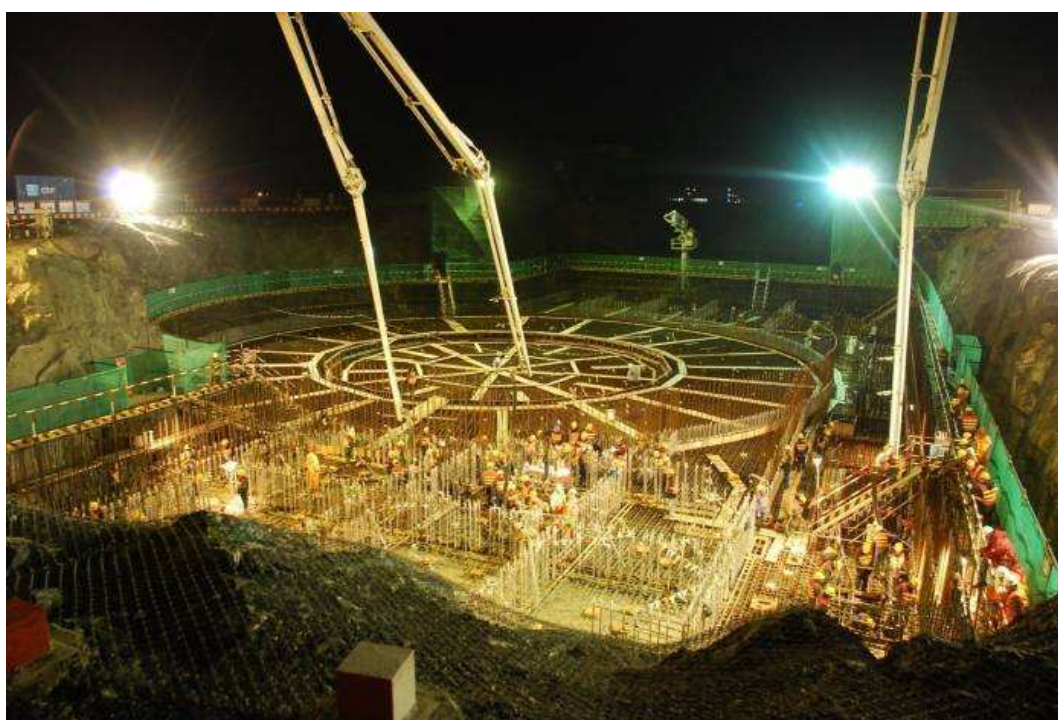
Fig. 1. Hormigonado de los cimientos en el emplazamiento del proyecto nucleoeeléctrico de Sanmen (China).
