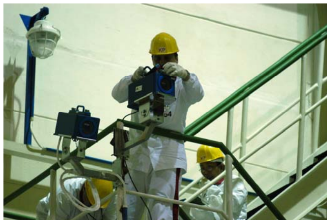
图 2. 在核设施安装监视设备。
