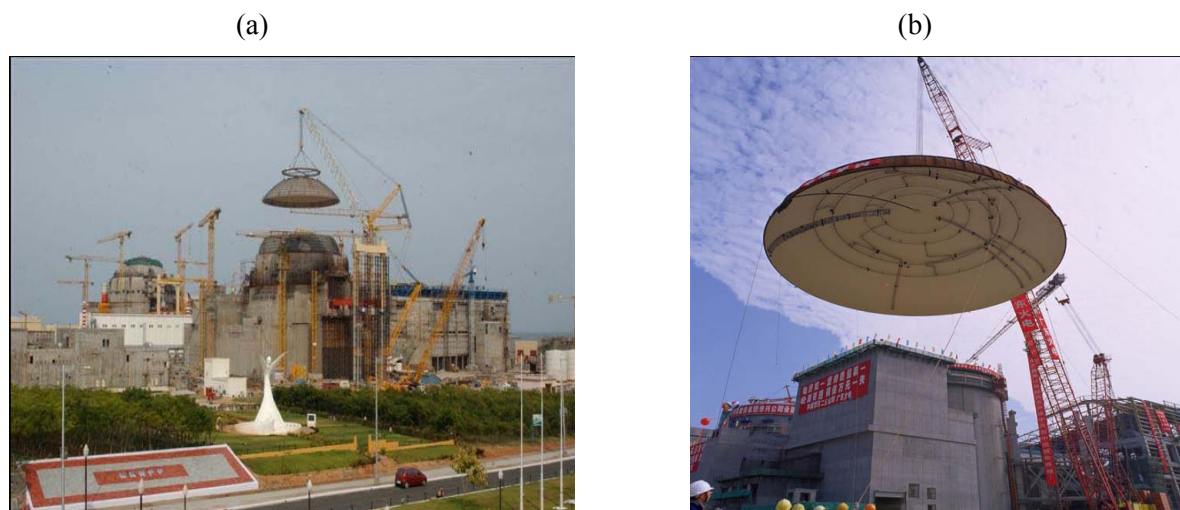
图 2. 吊装安全壳穹顶就位：(a) 印度库丹库拉姆核电厂（照片由印度核电公司提供）； (b) 中国岭澳核电站 4 号机组。
