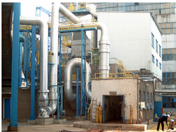
Рис. 1. Опытная установка для электронно-лучевой обработки отходящих дымовых газов на теплостанции "Марица Восток-2" в Болгарии.
