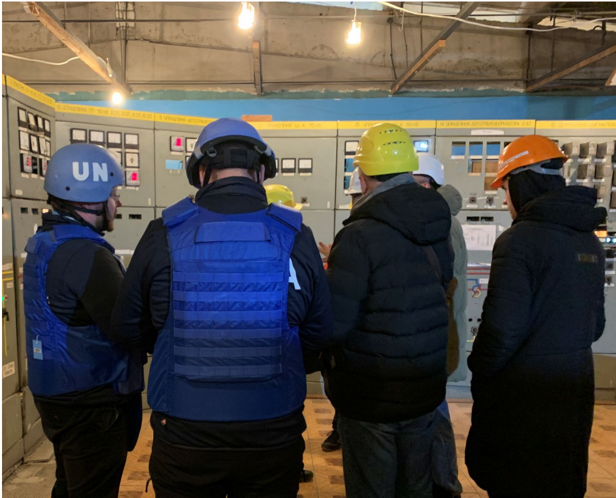
Des membres du personnel de l'Agence font le point sur le processus de restauration dans la salle de commande de l'un des postes visités, le 25 février 2025. (Photo : NEK Ukrenergo)
