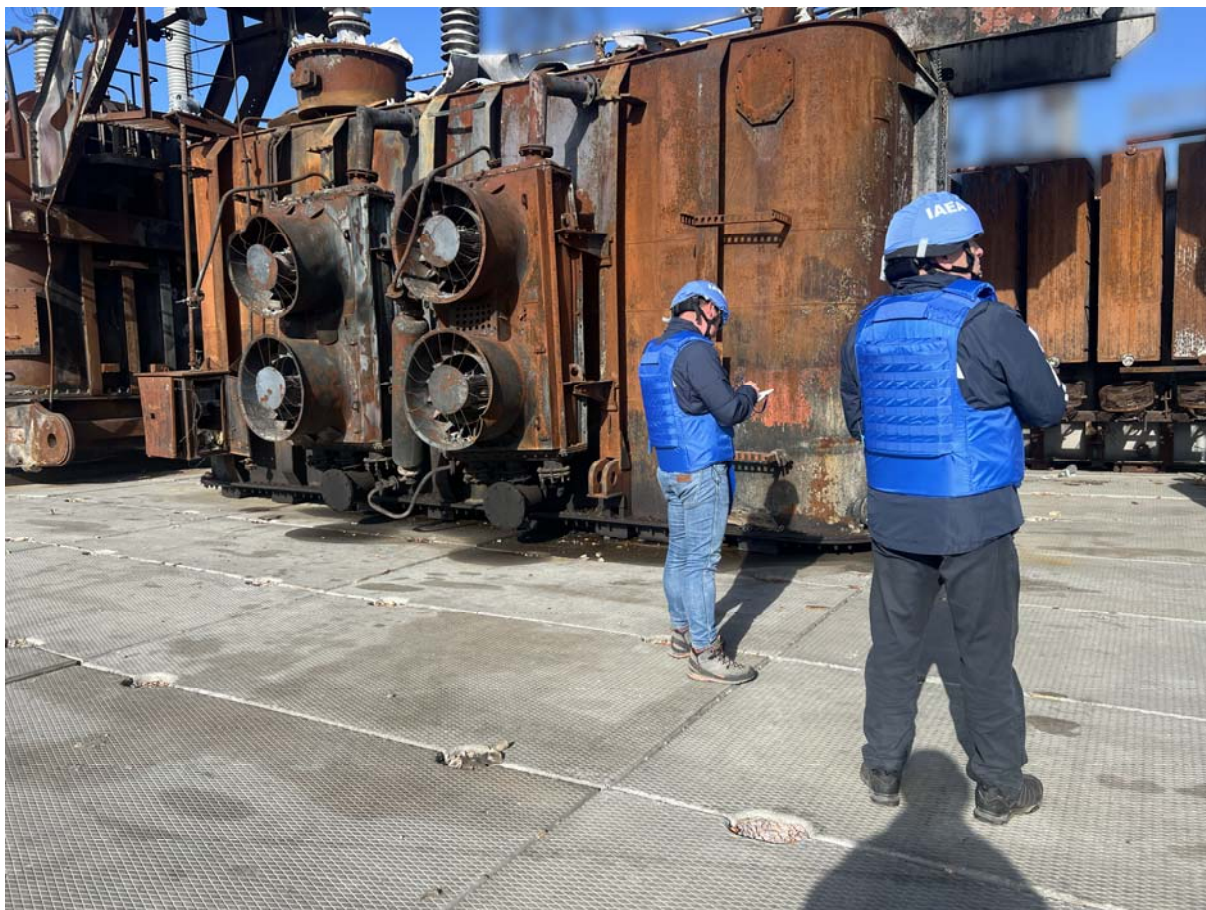
Personal del Organismo durante la visita a la subestación de 750 kV Dniprovska el 24 de octubre de 2024. (Fotografía: UKRENERGO)
