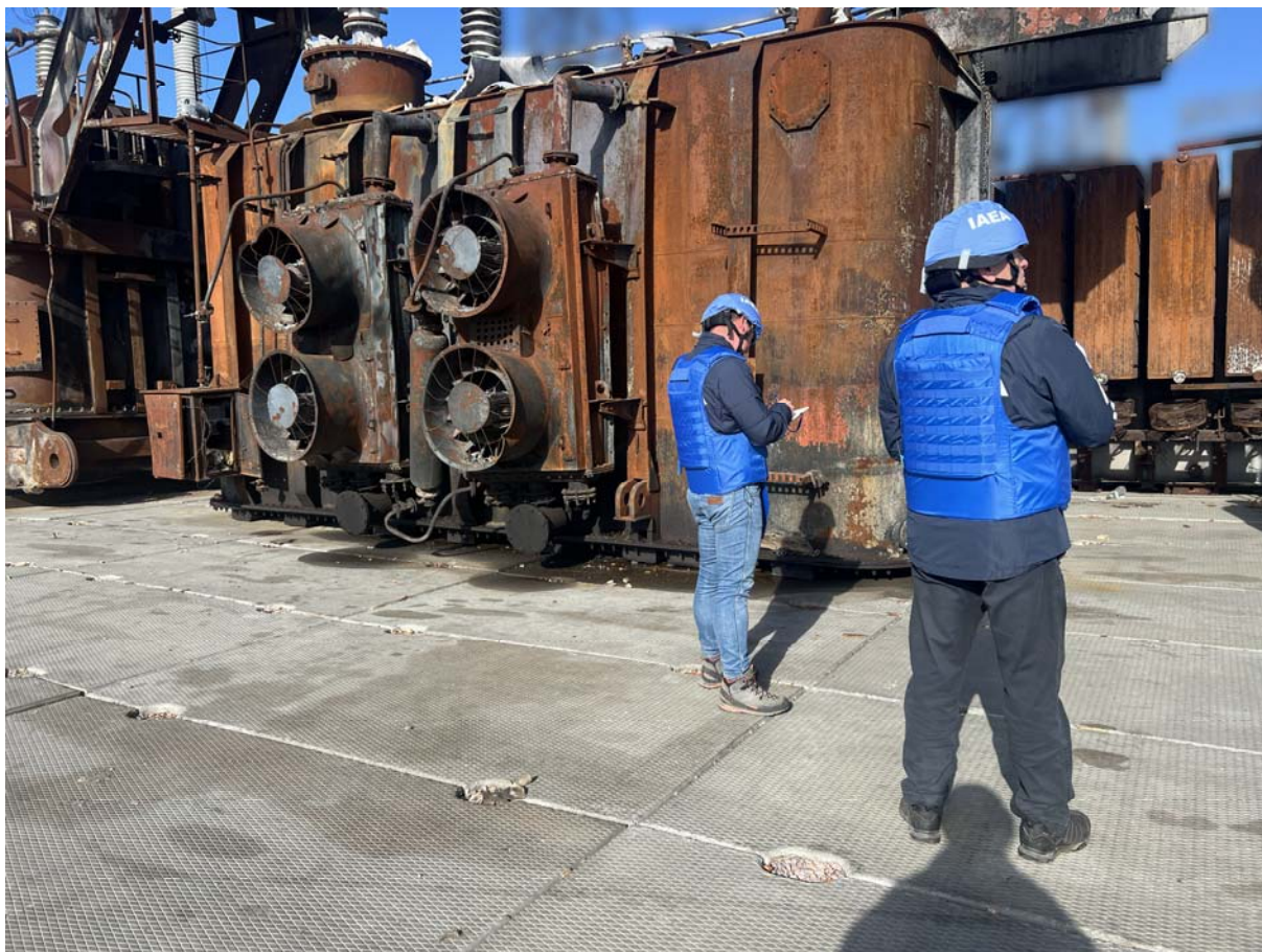
Des membres du personnel de l'Agence lors de la visite du poste de 750 kV de Dniprovskia le 24 octobre 2024. (Photo : UKRENERGO)
