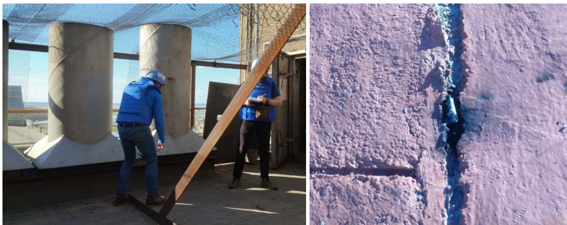
La ISAMZ en la azotea del edificio de reactor de la unidad 6 cuando comenzó el tiroteo (izquierda) y un primer plano de los restos de la cápsula de batería (derecha). (Fotografía: ZNPP)
