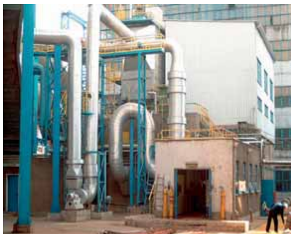
FIG. 1 .Planta experimental para el tratamiento de gases de combustión por haces de electrones en la central termoeléctrica de Maritsa Este II de Bulgaria.
