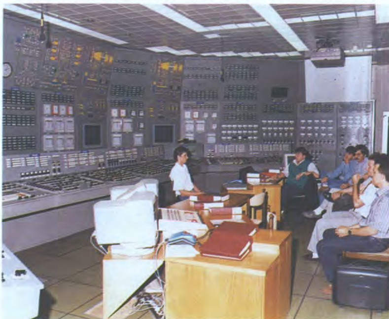
在波克什核电厂进行的现场模拟器培训,正在 WWER 设施工作人员和管理人员中树立“安全文化”意识。(来源:波克什核电厂)
