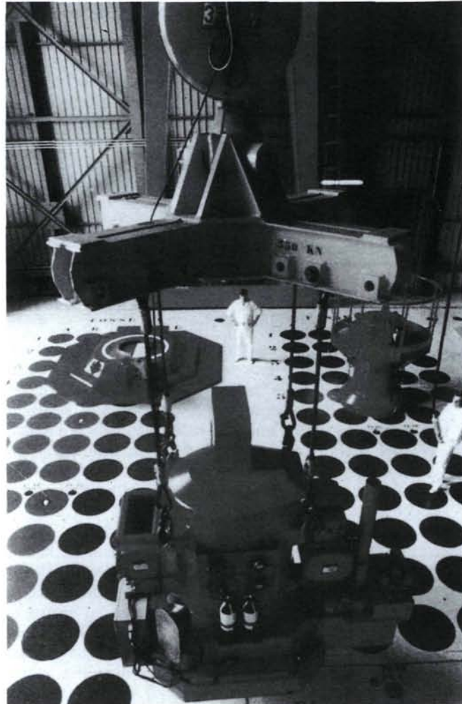
En la instalación de Marcoule, en Francia, recipientes de desechos de actividad alta vitrificados se transfieren a pozos refrigerados por aire para su almacenamiento provisional. (Foto: ANDRA)
