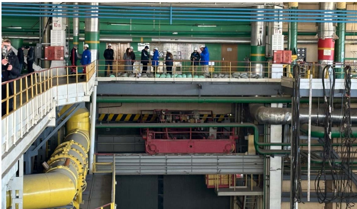
El Director General, Rafael Mariano Grossi, durante su visita a la sala de turbinas de la unidad 4 en la ZNPP, el 7 de febrero de 2024.
