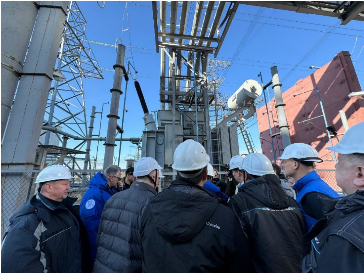
Генеральный директор Рафаэль Мариано Гросси осматривает резервные силовые трансформаторы на ЗАЭС 7 февраля 2024 года.
