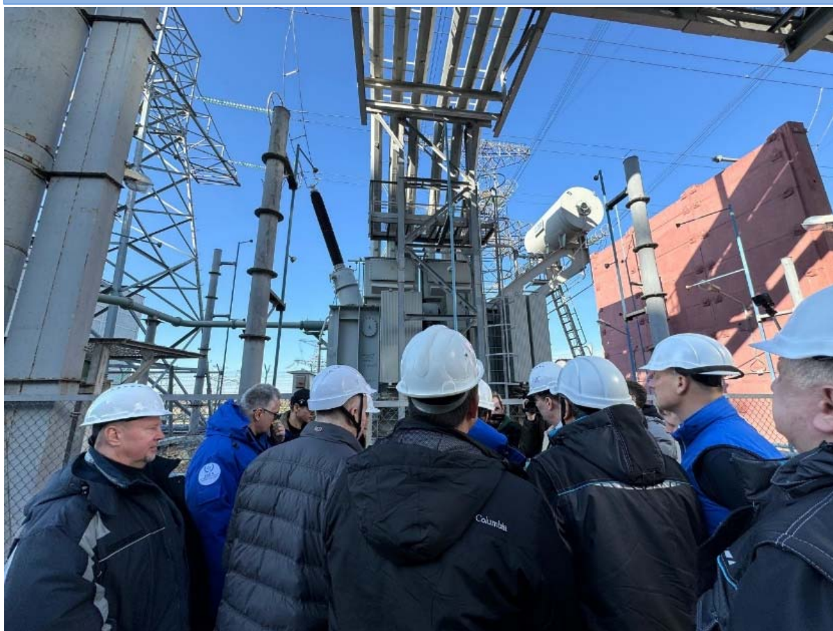
Le Directeur général Rafael Mariano Grossi observe les transformateurs d'alimentation de secours de la centrale nucléaire de Zaporizhzhia, le 7 février 2024
