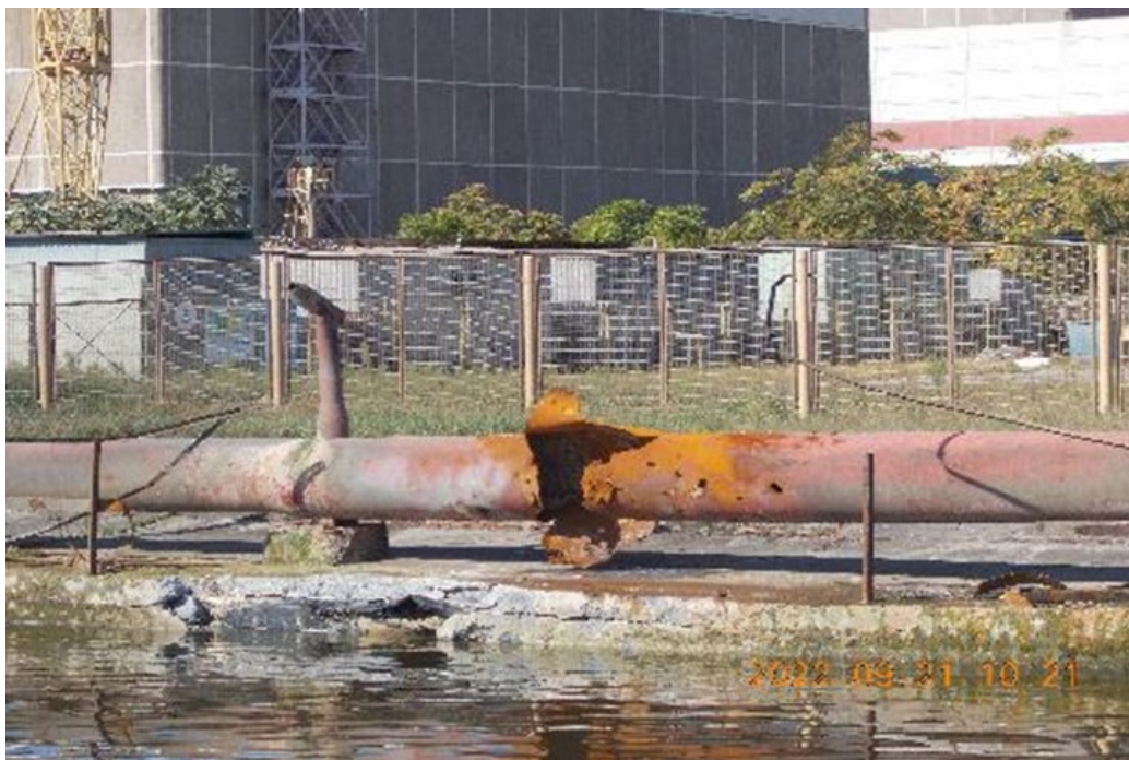
9 月 21 日，扎波罗热支援工作组在扎波罗热核电厂厂区观察到因炮击而断裂的管道 (照片来源：原子能机构)。
