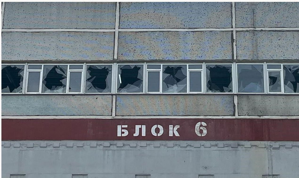
炮击对 6 号机组高架通道造成的损坏。（照片来源：原子能机构）
