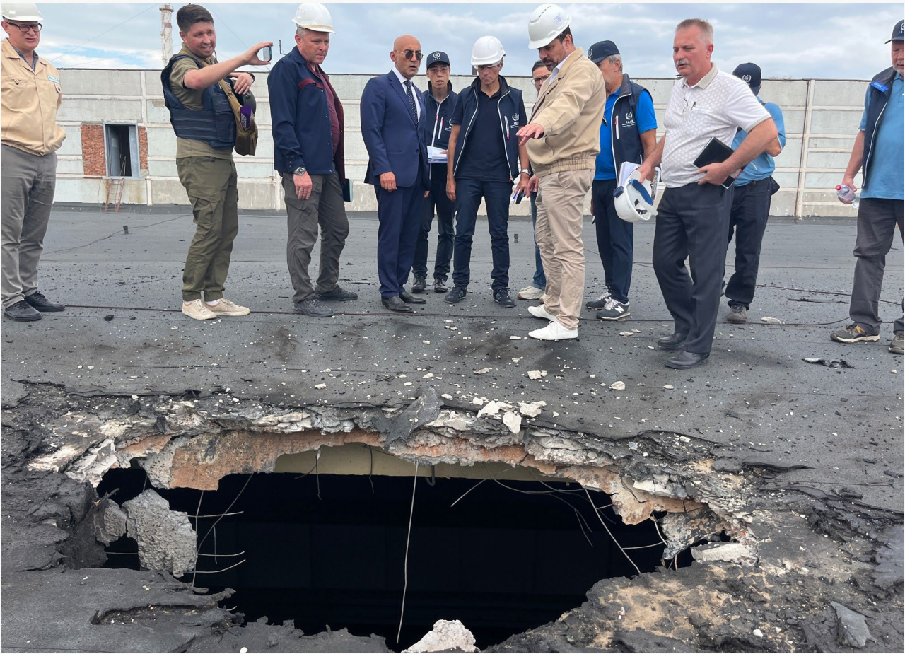
原子能机构工作组在查看炮击对扎波罗热核电厂有新鲜核燃料等物项和固体放射性废物贮存设施的专用建筑屋顶。（照片来源：原子能机构）
