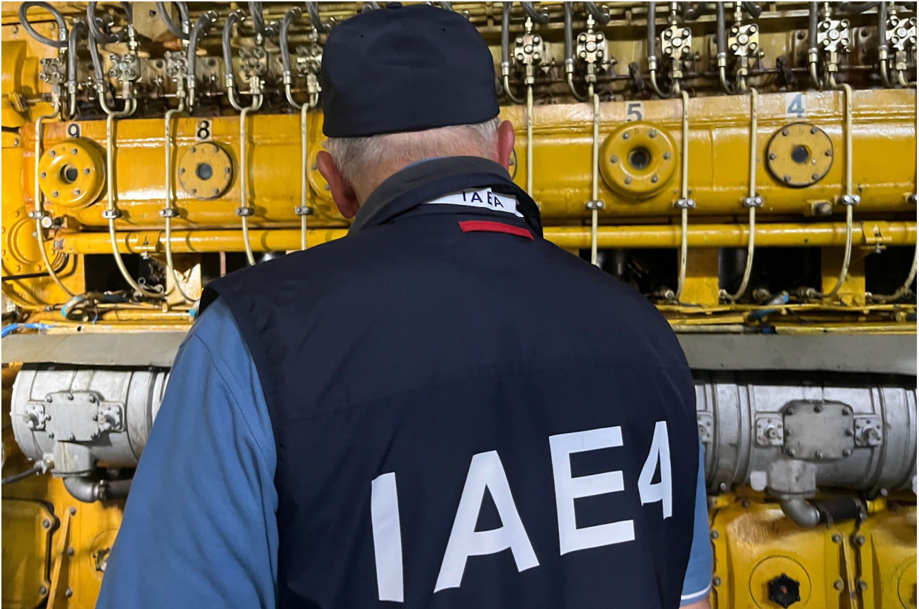
原子能机构专家视察扎波罗热核电站5号机组的应急柴油发电机房。（图片来源：原子能机构）
