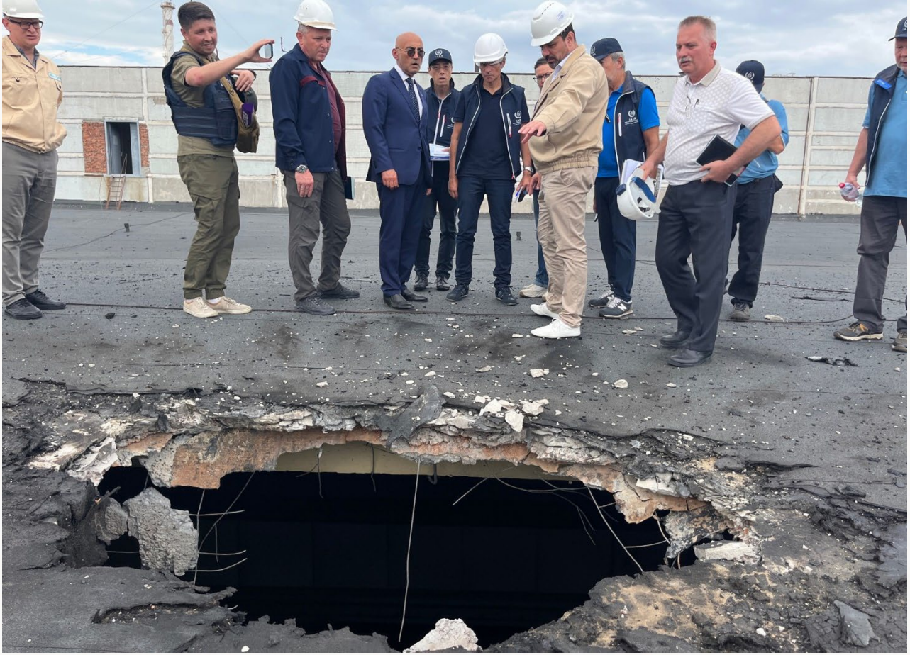
فريق الوكالة يرصد الأضرار التي ألحقها القصف بسقف المبنى الخاص في محطة زابوريجيا، الذي يحتوي، من بين مفردات أخرى، على الوقود النووي الطازج ومرفق خزن النفايات المشعة الصلبة. (الصورة من: الوكالة الدولية للطاقة الذرية)
