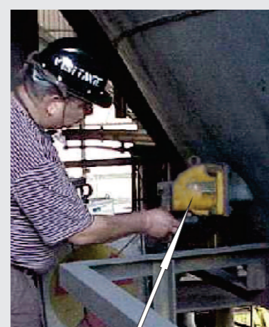
Boîtier de la source d'une jauge de niveau contenant une source gamma. Le détecteur est de l'autre côté de la cuve.
