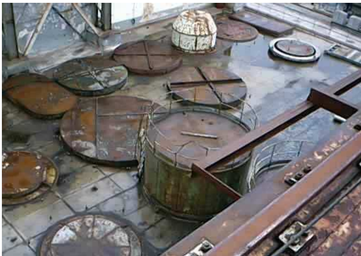
Фото №3 Пробки технологических отверстий
