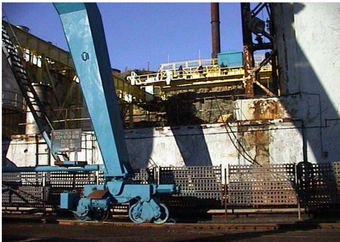
Фото 4. Вид мостового крана МК 20/5
