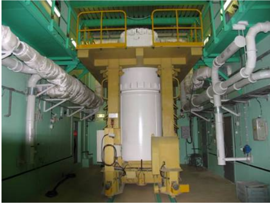
Рис. 1. Контейнер ТУК-120 внутри хранилища. Холодные испытания
